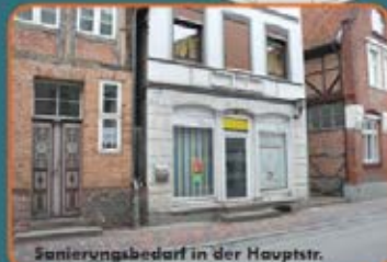
Sanierungsbedarf in der Hauptstr.
